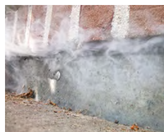
Prova di impermeabilizzazione difettosa dei giunti alle pareti sopra a un garage sotterraneo.
