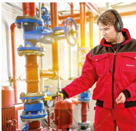
Sulle pompe e sulle altre macchine da lavoro è possibile constatare tempestivamente i segni di usura, grazie alla sonda per le vibrazioni meccaniche.
