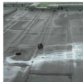
Applicazioni tipiche sono, ad esempio, l'esame di tetti piani per rilevare un difetto di tenuta mediante il test del colorante.
