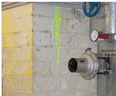
Localizzazione di una condotta dell'acqua non a tenuta nell'edificio, tramite introduzione di fluorescina e ispezione UV.
